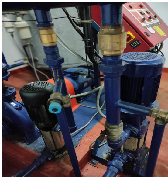
CONTRA INCENDIOS EXTERIOR
